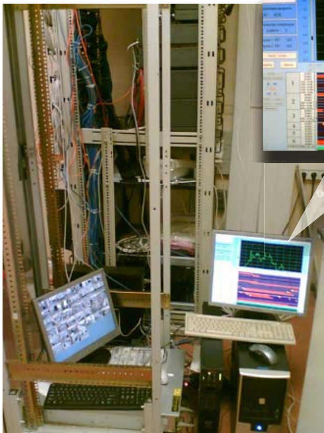
◀ Серверная с установленной системой InTouch
